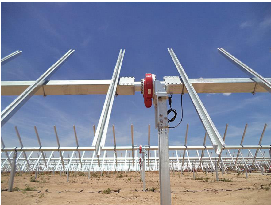
Fotografia 4.15 – Estrutura de suporte de painéis fotovoltaicos (fixa ao solo) (Fonte: https://soltec.com/ )
