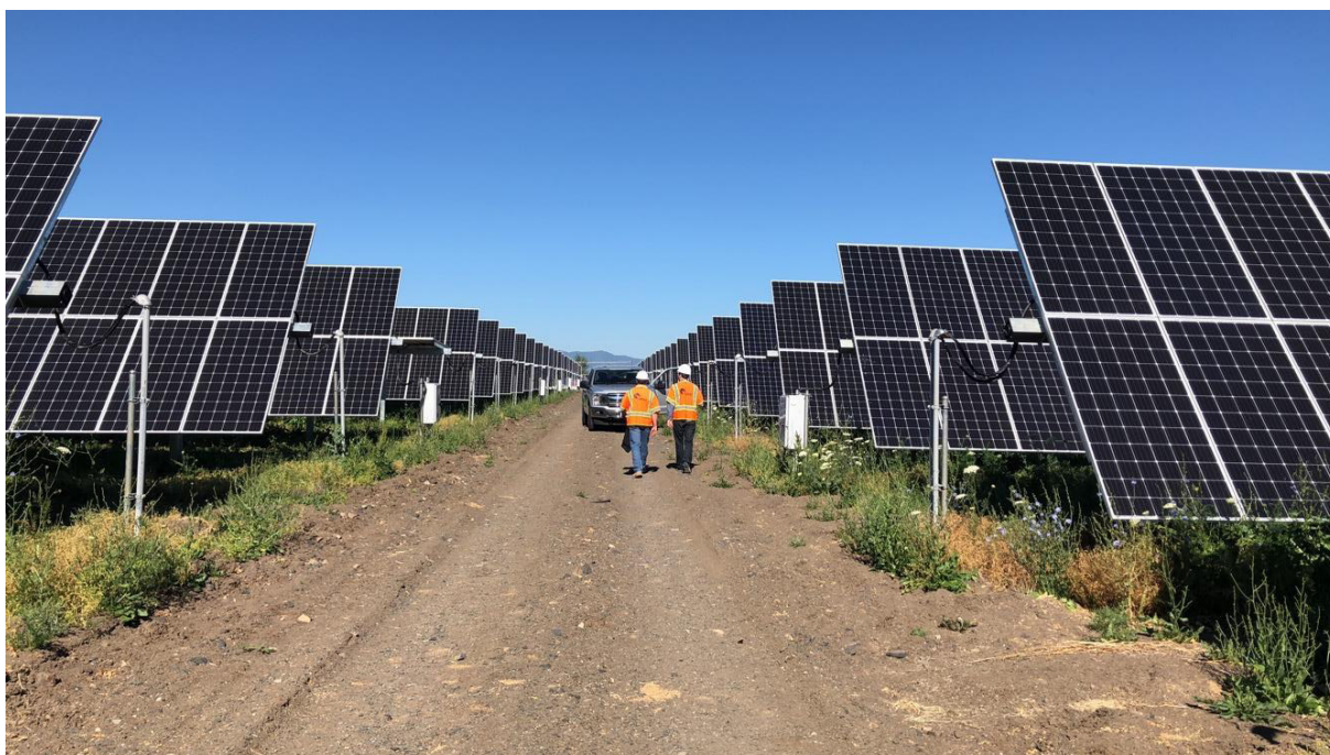
Fotografia 4.16 – Exemplo da estrutura com os módulos fotovoltaicos instalados ( https://soltec.com/ )
